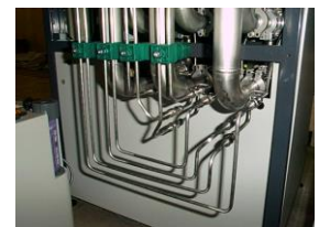
Gasleitungen, Abgasleitungen, Gasentsorgung, Gaswäscher
