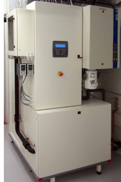
Klimagerät mit Temperatur-, Feuchte- und Überdruckregelung
