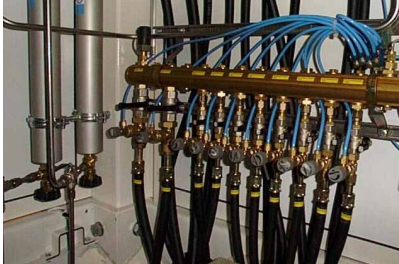
Anschluss an Kühlwasser, CDA (clean dry air)
