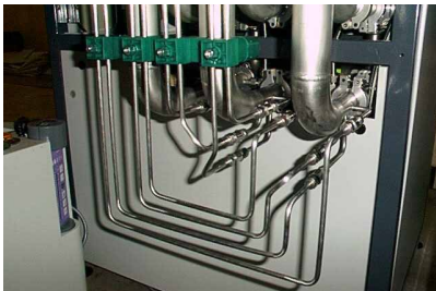
Gasanschlüsse, Gasreinigungsanlagen, Gaswäscher
