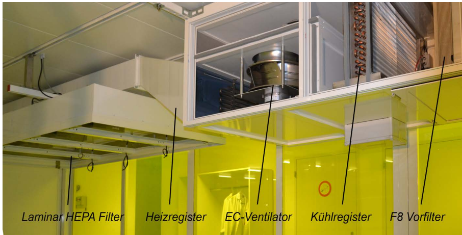
Anwendung Deckeneinheit mit abgesetzter Luftaufbereitung für ISO5-Laminar-Arbeitsplatz 4000 m 3 /h
