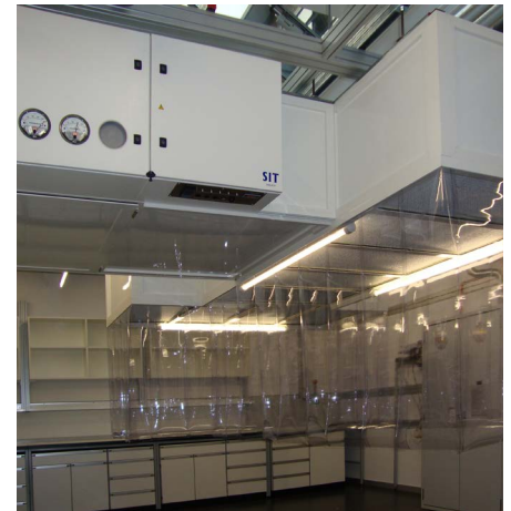
Luftaufbereitung 7000 m 3 /h mit hoch genauer Temperaturregelung in der Laserforschung
